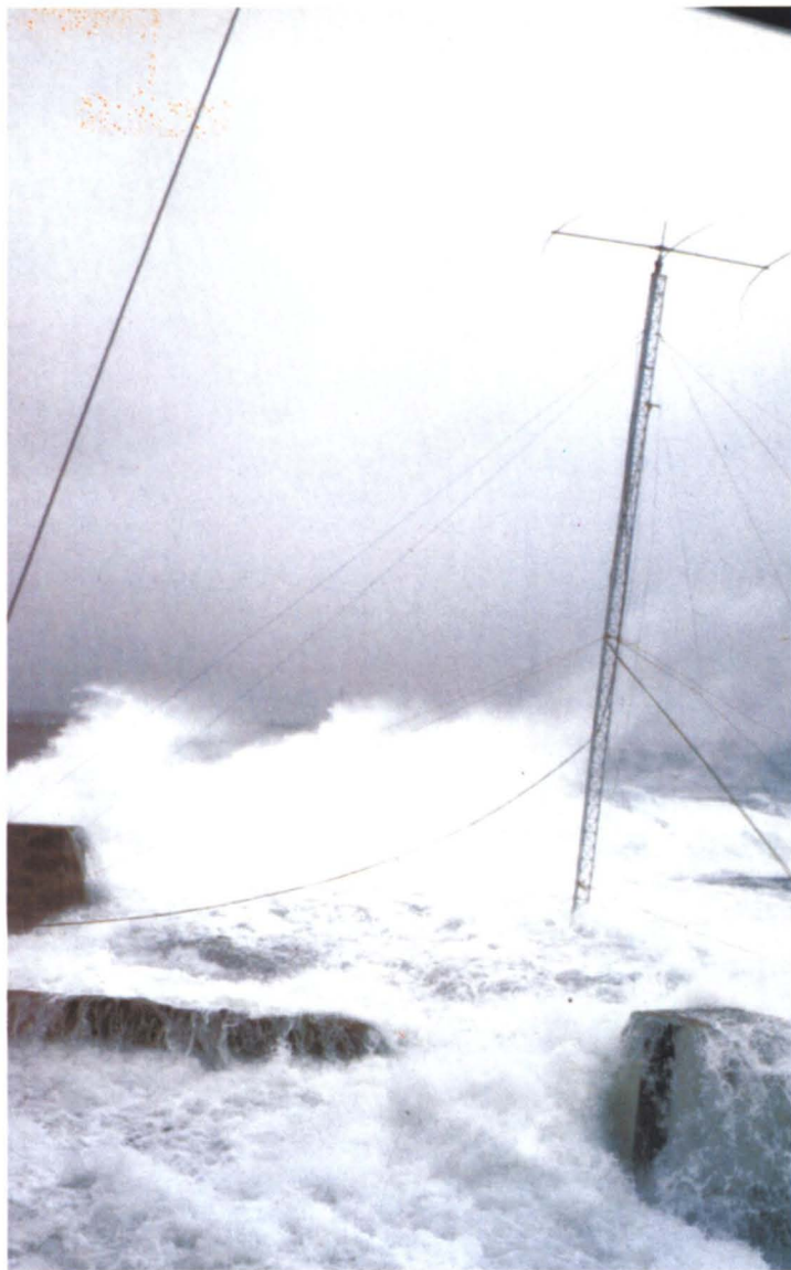
Cualquier sitio puede ser bueno para instalar una torre que soporte una direccional para 40 metros, aunque convendría hacer previsiones sobre el estado del mar. En este caso, es el mar Báltico cubriendo Market Reef.
