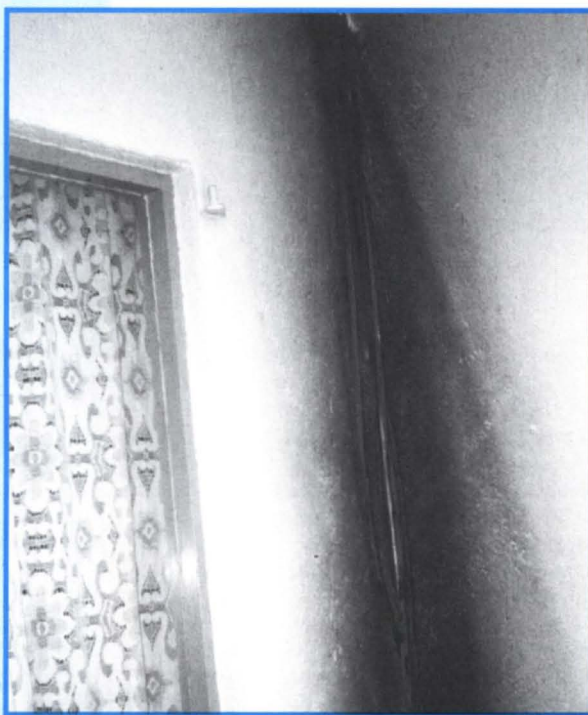
1.- Por aquí pasó la descarga del rayo camino del rotor o proviniendo del rotor, que lo hizo puré. La huella es patente. Si el rayo hubiese caído en la casa de enfrente, o a diez kilómetros, no hubiese dejado este rastro.
