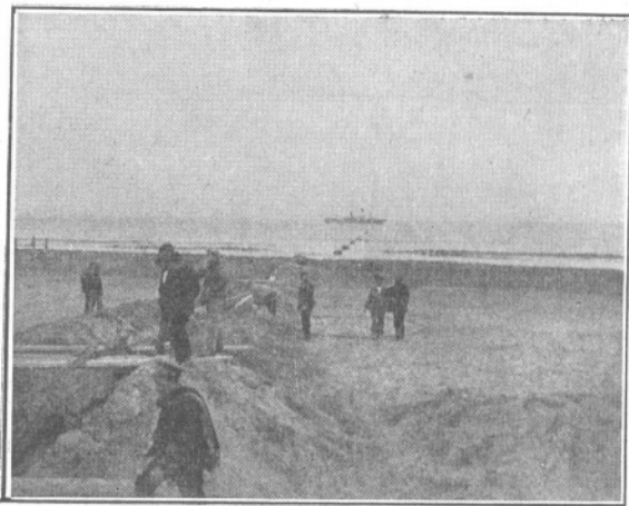
Zanja por donde se lleva el cable desde la costa a la caseta de amarre.
